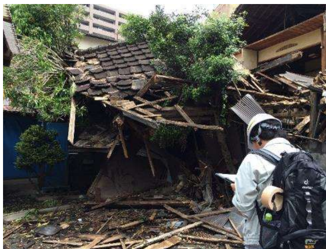
被災建築物応急危険度 判定(熊本地震)
