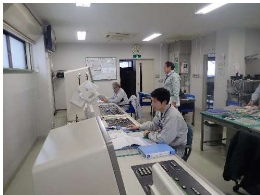
青森空港での航空灯火監視状況
