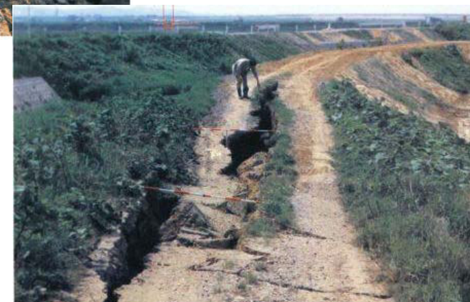
沈下事例② ▶ 岩木川水系 中里川
