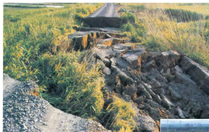
◀ 沈下事例① 岩木川水系 山田川
