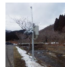
河川監視用カメラ
