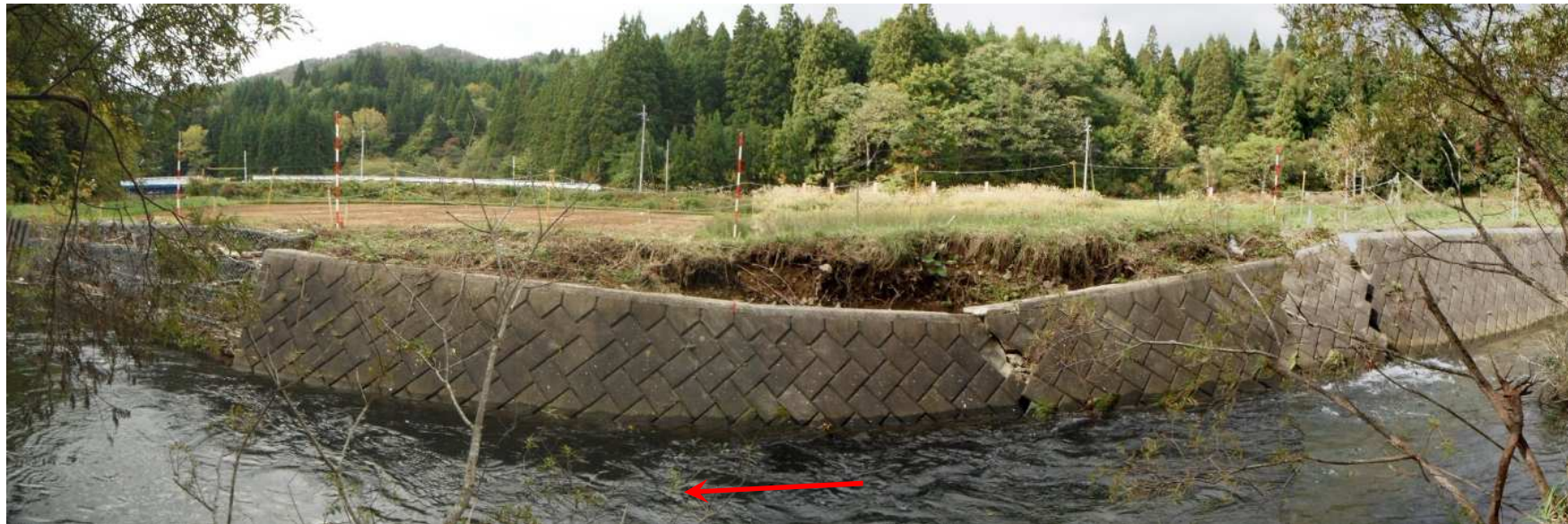
■二級河川 脇野沢川(むつ市) 被災状況
