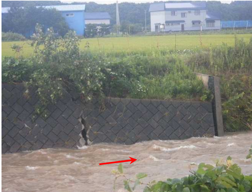
■二級河川 相内川(五所川原市) 被災状況
