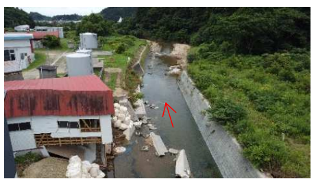
▲倉庫の被災状況
