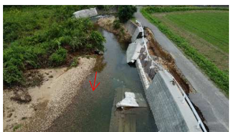
▲護岸崩壊の状況
