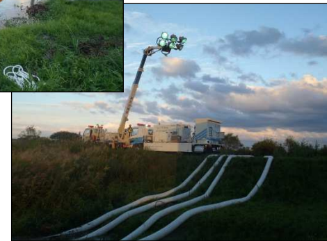
赤川破堤時の排水活動(東北町 H28 台風9号)
