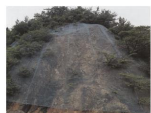
▼落石防護ネット
