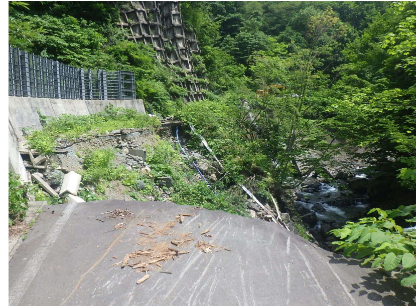
△被災箇所の現状（令和7年7月撮影）
