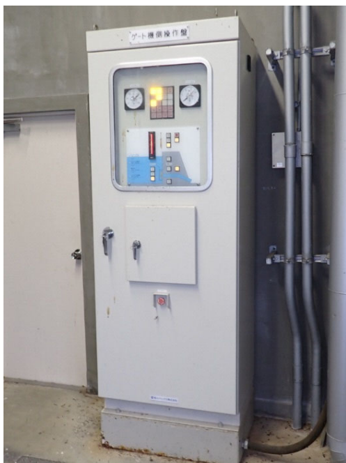
図 予備ゲート機側操作盤（既設）
