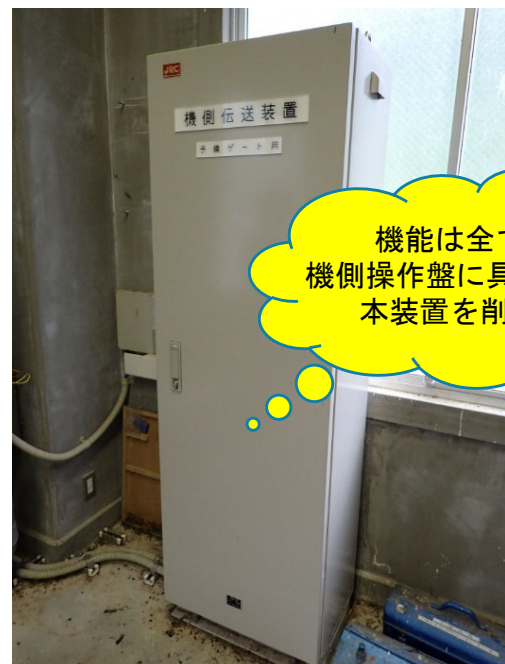
図 機側伝送装置（既設）
