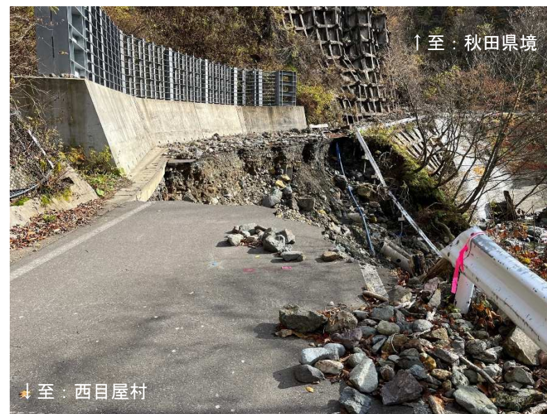
被災時の状況（令和4年11月撮影）
