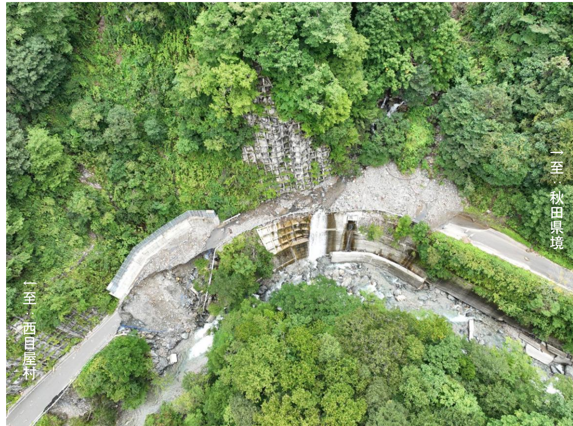
△被災箇所上空全景（令和4年9月撮影）
