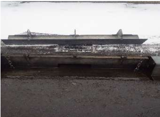
蓋撤去 橋面冠水対応
