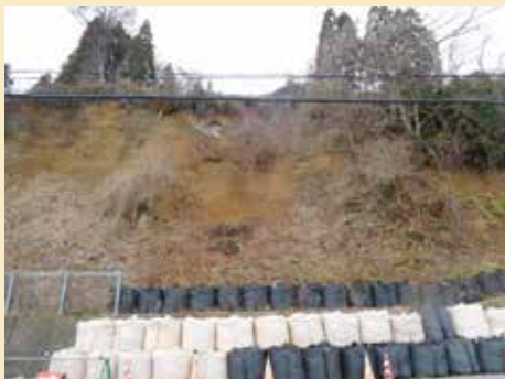
施工前(要対策)
