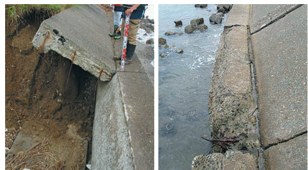
護岸背後の空洞化
