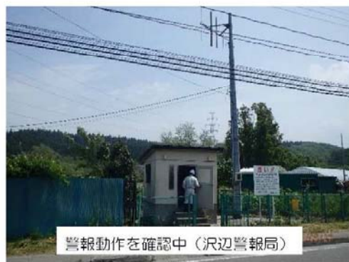
サイレン等の起動
