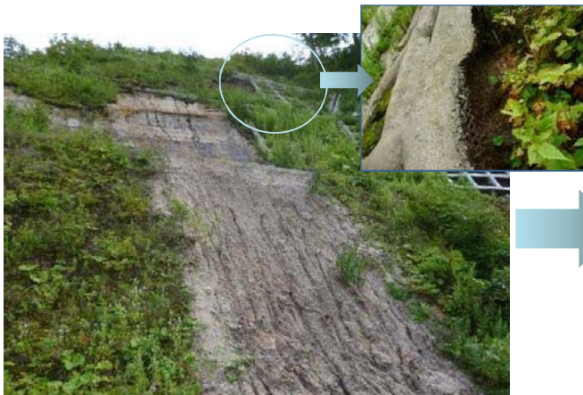
法面崩落状況（過年度施工の植生工及び簡易法枠工）
