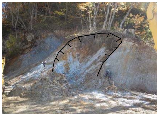
法面崩落状況（安定勾配で掘削した切り土法面）
