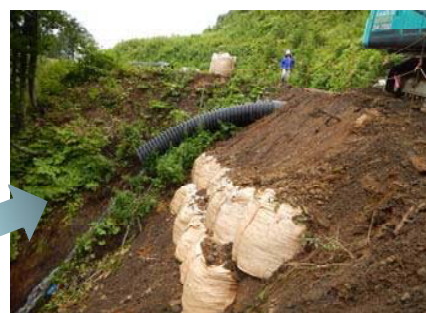
沢水処理状況
