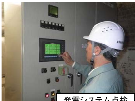
発電システム点検
