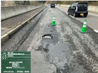
パトロールによる変状確認
