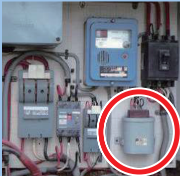
低圧分電盤内の 低圧コンデンサー
