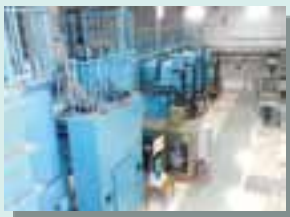
浸出水処理施設内部
