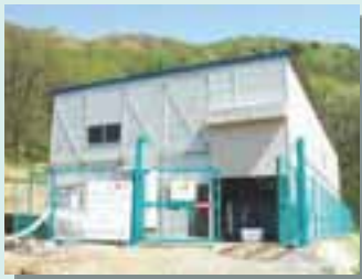
仮設浄化プラント (H17.7 撤去)
