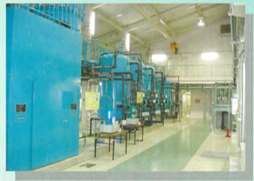
処理施設内部
