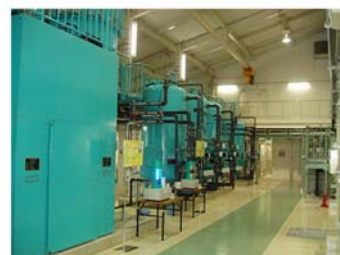
しんしゅつすいしよりにせつ ないぶ 浸出水処理施設の内部
