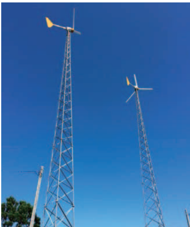
青森県下北郡大間町 「Excel10」設置状況
