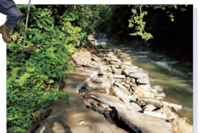
暗門溪谷ルート被害状況
