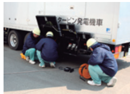
電源車による電源供給
