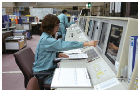
運転管理(制御盤操作)
