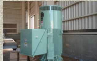
非常用冷却海水系ポンプの予備品
