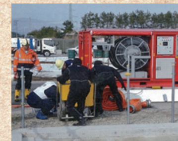
中型移送ポンプによる給水
