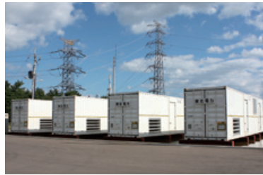
電源確保対策の大容量電源装置
