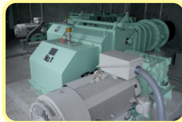
クロスフロー水車・発電機
