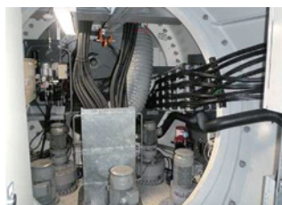
ナセル（発電機等の機器収納部）内部
