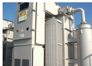
昇圧用変圧器
