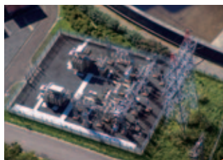
屋外変電設備
