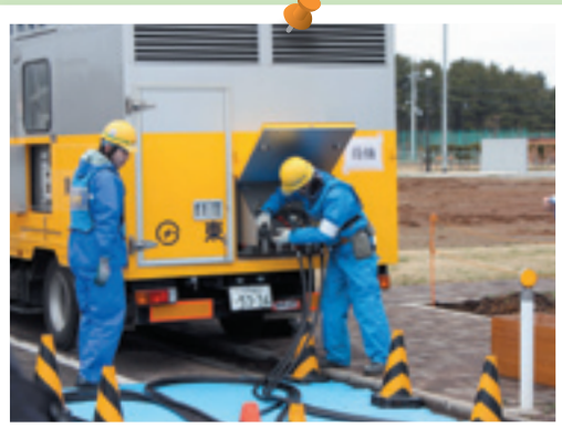
電源車への接続訓練(東北電力(株))
