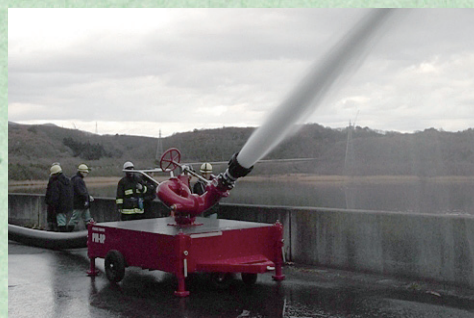
〈放水砲の配備〉
