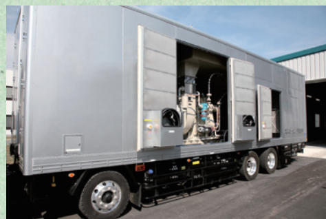
〈電源車の配備〉
