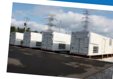
大容量電源装置の設置
