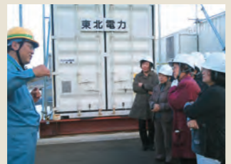
大容量電源装置見学の様子
