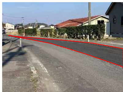
薄層舗装によるひび割れ進行の抑制
