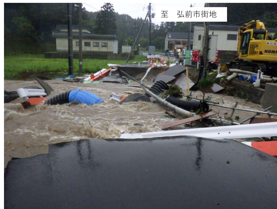
被災した仮設道路
