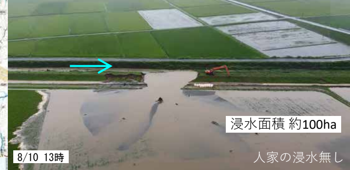
中里川破堤状況
