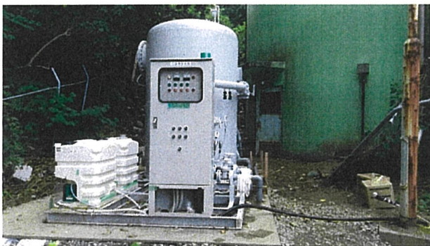
浄水処理ユニット
