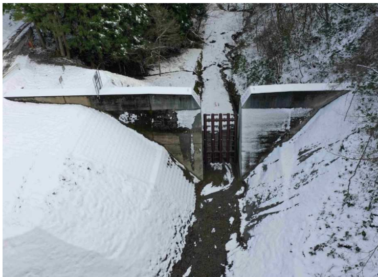
■道前沢（砂防メンテナンス）砂防堰堤工事_田子町 完成検査：令和6年2月27日
