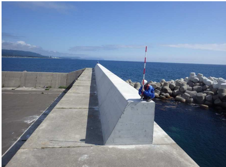
■ 白糠地区漁港施設機能強化工事_東通村 完成検査：令和5年9月8日
