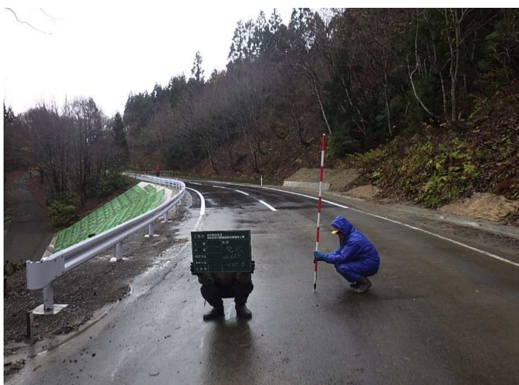
■青森五所川原線道路災害復旧工事_五所川原市 完成検査：令和5年12月13日
