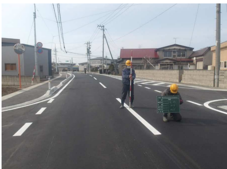
■松野木姥菟線道路交通安全施設整備工事_五所川原市 完成検査：令和6年3月29日
