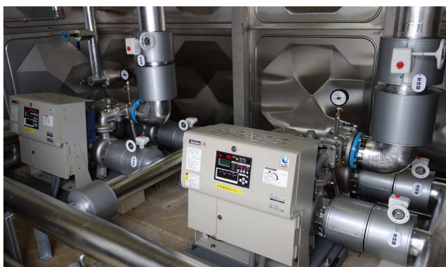
■青森県自治研修所給水ポンプ更新工事_青森市 完成検査：令和6年3月22日
