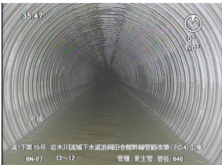
■岩木川流域下水道浪岡田舎館幹線管路改築(その4)工事_田舎館村 完成検査：令和5年10月20日
