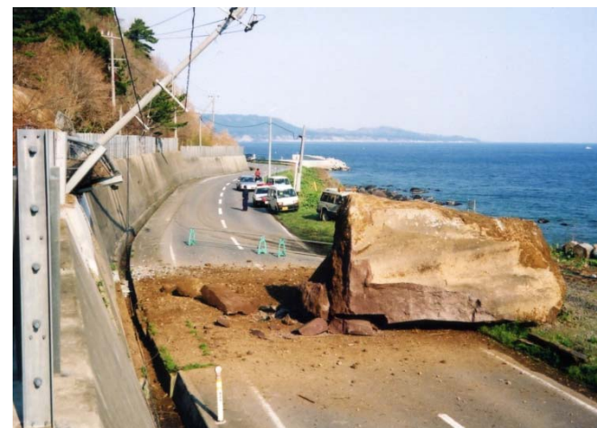
【国道279号落石現場(風間浦村内、H15.5)】
