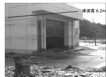
馬淵川流域下水道 八戸汚水中継ポンプ場
