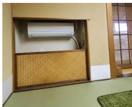
更新後の客室エアコン設備
