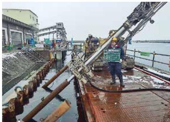
グラウンドアンカー工法による陸揚げ岸壁の耐震化 (三沢漁港)
