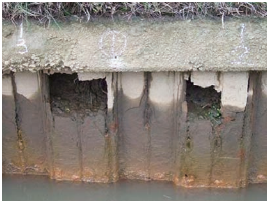
水路の老朽化
