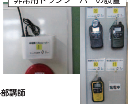
非常用トランシーバーの設置
