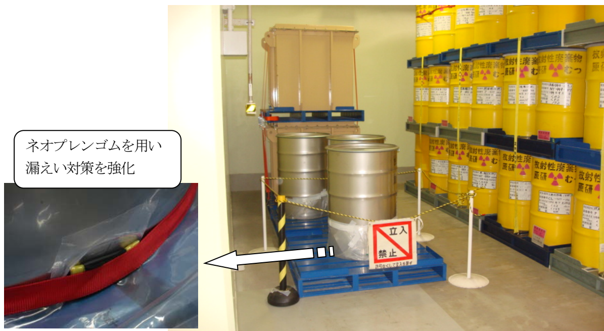
写真2 固体廃棄物貯蔵室内の貯蔵状況 (漏えいを確認し拡大防止のための養生を実施し保管)
