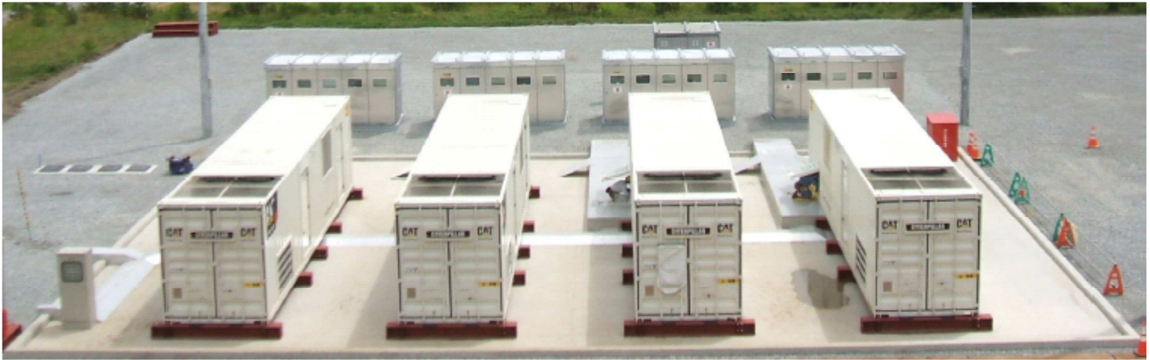
写真1 大容量電源装置の設置状況
