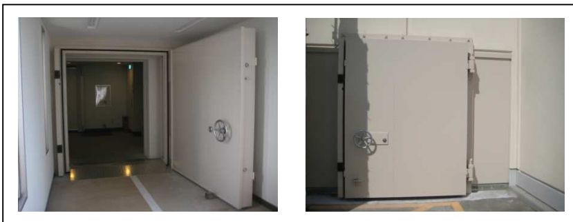
建屋入退域ゲート手前の水密扉
