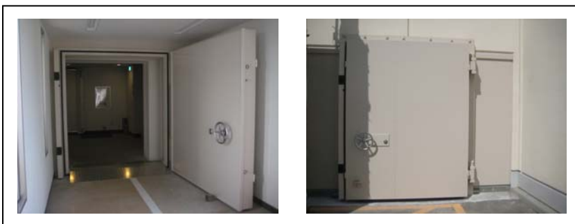
建屋入退域ゲート手前の水密扉
