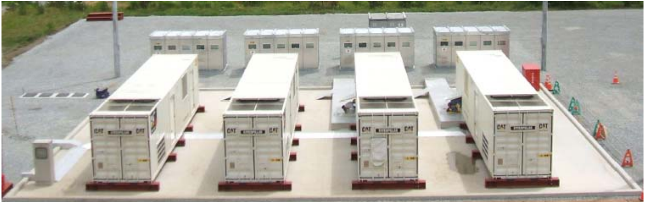
写真1 大容量電源装置の設置状況
