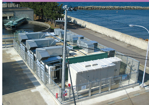
消化ガス発電設備全景
