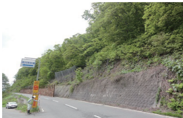
落石危険箇所 (一般県道酸ヶ湯高田線 青森市)
